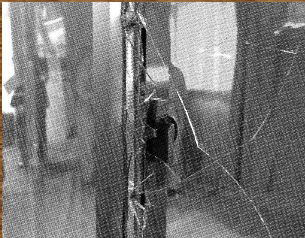
複層ガラスが破られた状態
